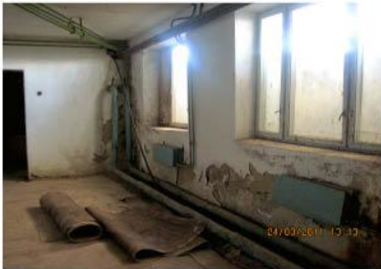
Фото 5. Клуб до ремонту, с. Юрївка
